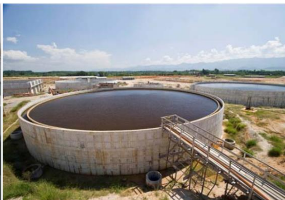
Εικόνα 29. Εγκαταστάσεις Επεξεργασίας Λυμάτων SABESP, Βραζιλία
