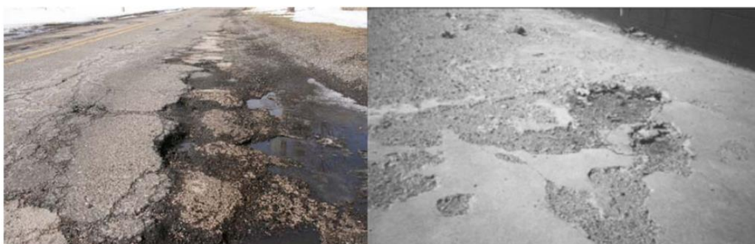
Εικόνα 9. Παράδειγμα φθοράς από πήξη – τήξη σε δρόμους και καταστρώματα γεφυρών
